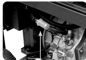
filtru de combustibil
